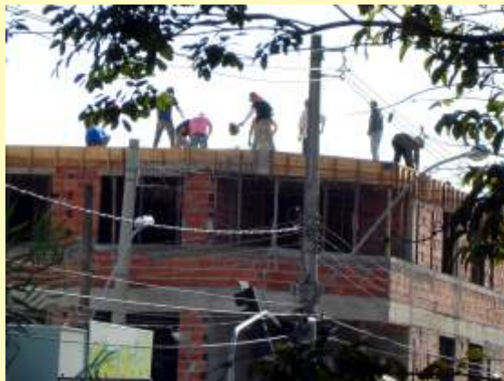
Obra em Araguari, trabalhadores sem nenhum equipamento de proteção
