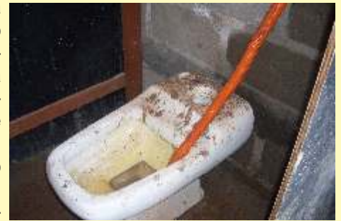
Banheiro em canteiro de obra sem a menor condição de uso pelos trabalhadores
